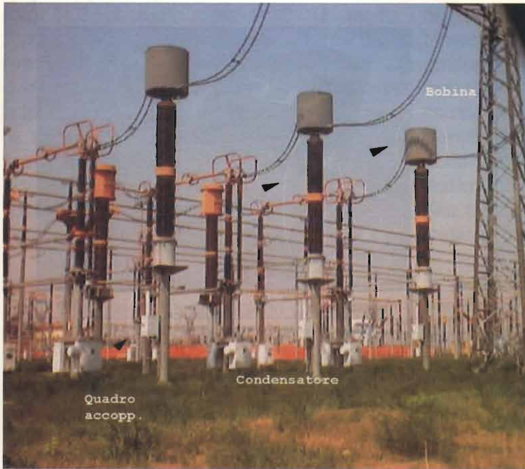
Figura 5 - Vista degli organi d'accoppiamento delle onde convogliate su elettrodotti a 380KV. Si vedono le bobine di sbarramento da 200mH (una per fase). Queste trovano supporto meccanico sul condensatore d'accoppiamento da 2000pF. Nel quadro vi è il trasformatore d'accoppiamento che provvede anche all'isolamento dall'impianto in tensione.
